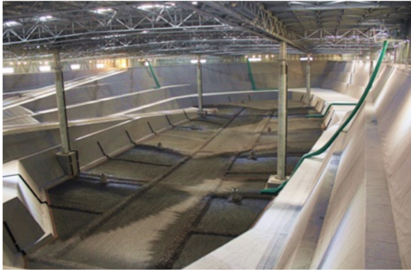
図 8.2-11 鹿児島県 環境整備公社 エコパークかごしま施設内景観 鹿児島県環境整備公社 HP
